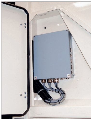
Wartungsklappe und Zentralelektrik
